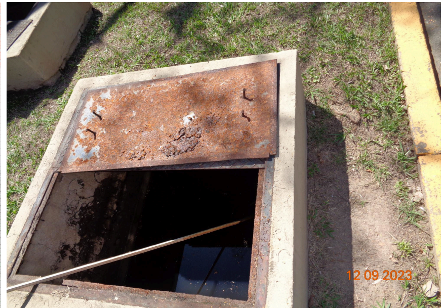
Fossa séptica do prédio 21 - Restaurante
