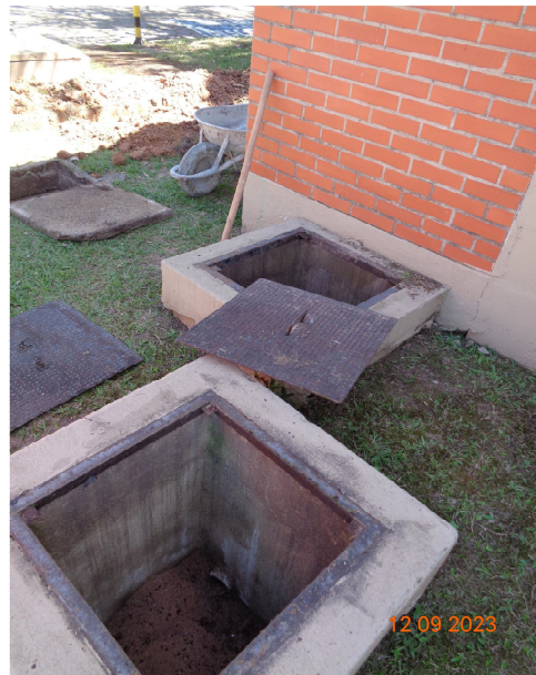
Caixa de passagem obstruída
